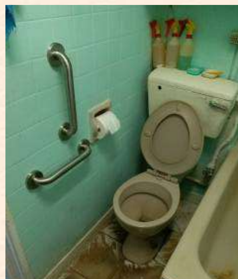
安装安全扶手及建议清洁用品安全放好
